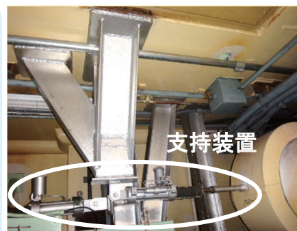
ナトリウム配管支持装置の性能アップや追加 (耐震補強工事の一例)
